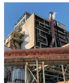
薬液回収ボイラー
